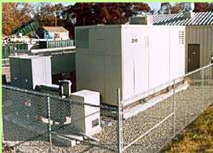
System generacji energii elektrycznej o mocy 200 kW z ogniwami PAFC
